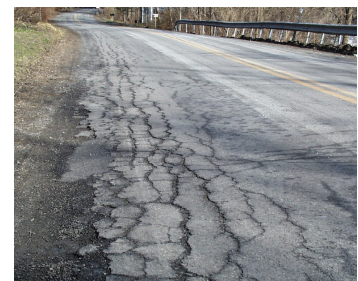
(c) Edge cracking
